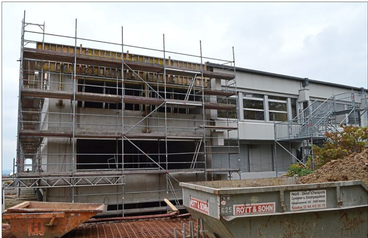
Der Erweiterungsbau an der Westseite der Rottenburger Realschule nimmt zusehends Gestalt an.
